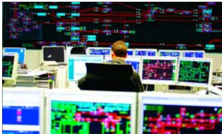
Control Center at Red Eléctrica de España (REE).
